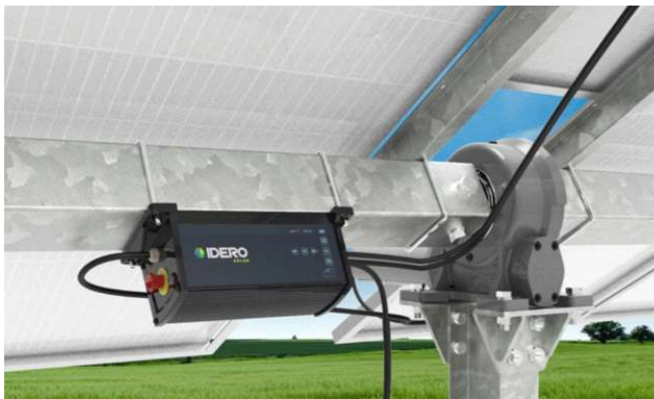
Figura 9. Equipo de seguimiento solar (tracker).
