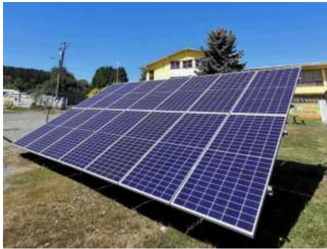
Figura 4. Sistema solar fotovoltaico: panel fotovoltaico.
