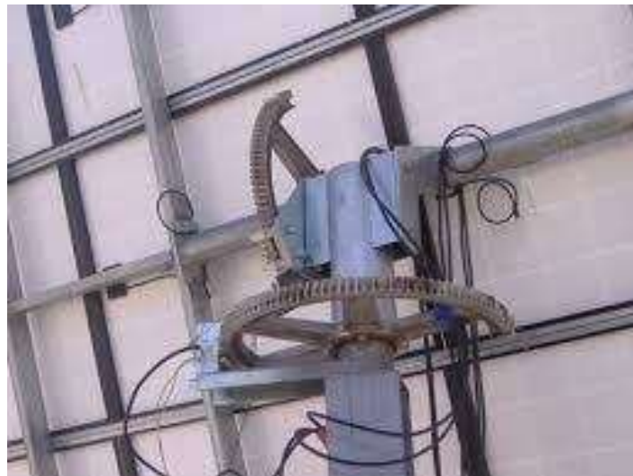
Figura 10. Seguidor solar de dos ejes.
